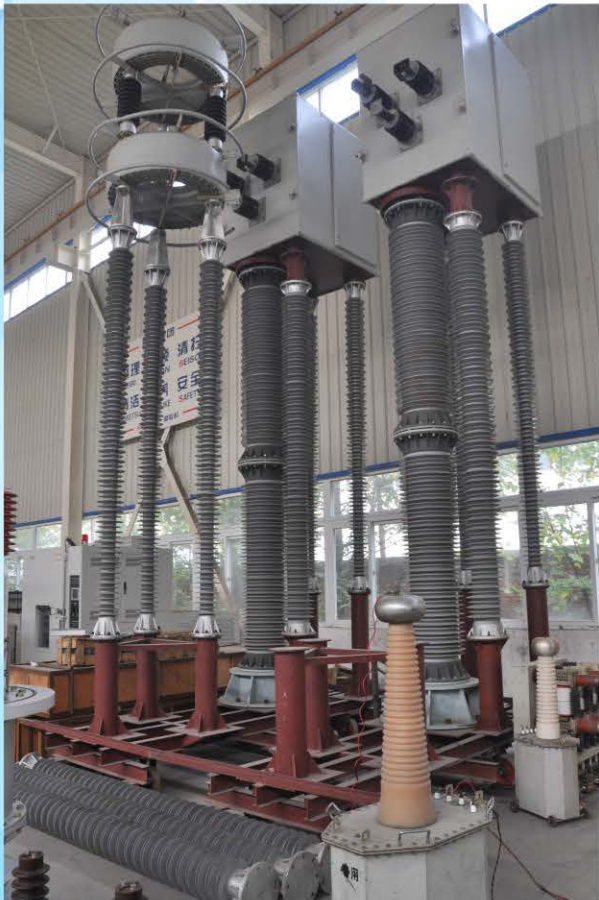
330kV限流器实验室
