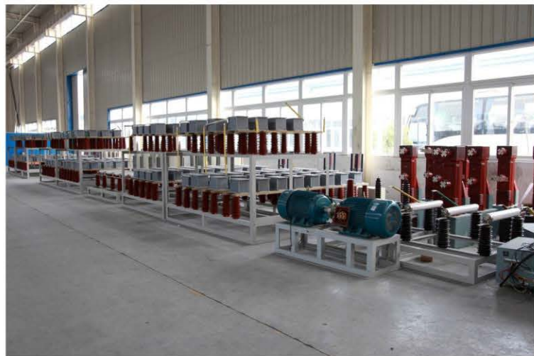
双电源切换实验室
